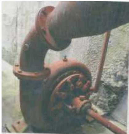
Abb. 35 Francis-Turbine von 1940 im Zustand von 2013
