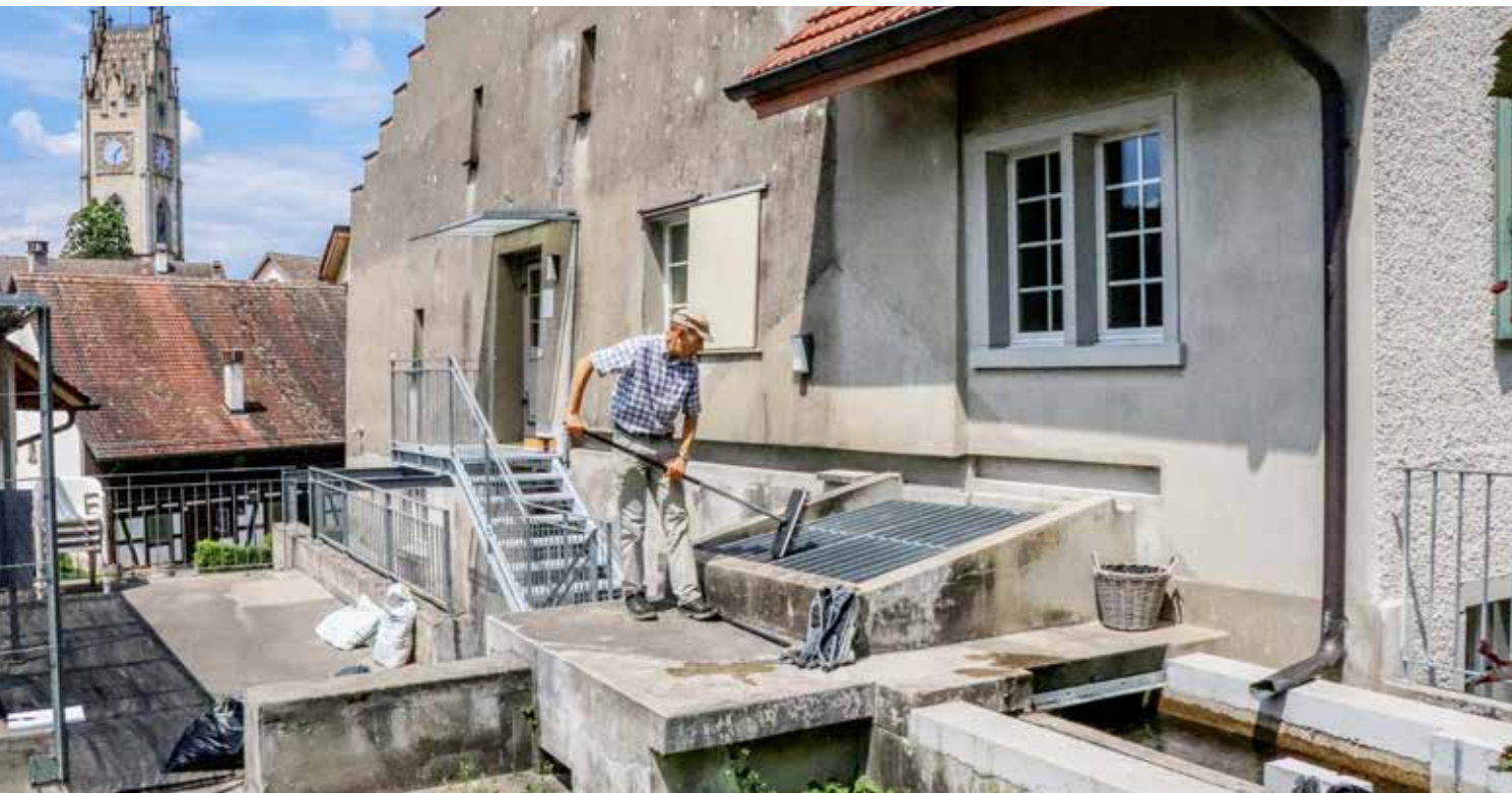
Der Mülibach (rechts) wird in einem Kleinstwasserkraftwerk zur Stromerzeugung genutzt. Peter Eichenberger reinigt von Zeit zu Zeit den Einlauf. Ein Grobrechen ermöglicht Kleinsäugern wie Mäusen und Igel den Ausstieg aus dem Kanal, ein Lochblech dient als Fischschutz. Bild: Benedikt Vogel
